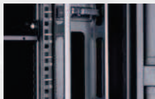
* Krytý prostor pro vedení kabelů
